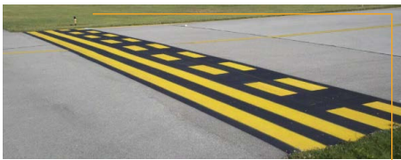
HOLDING POSITION: POSIZIONE DI ATTESA INGRESSO PISTA
